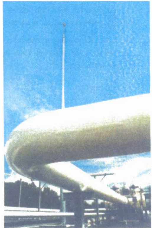
Hình 9.2. Ống dẫn khí ở nhà máy Dinh Cố (Bà Rịa – Vũng Tàu)
